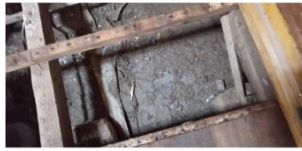
床下に残った泥の様子
